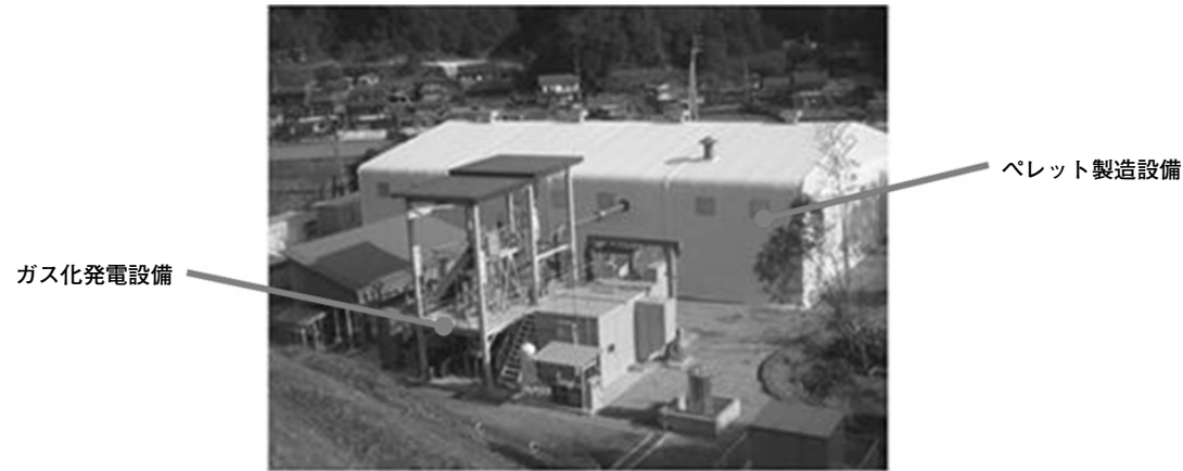
図6 実証試験設備 全景
