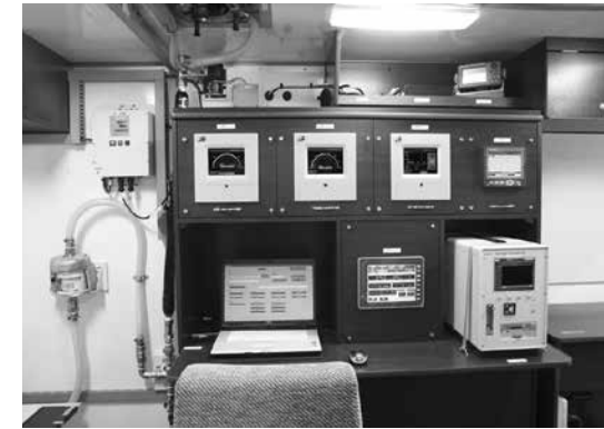
写真8 モニタリングカーの内部
