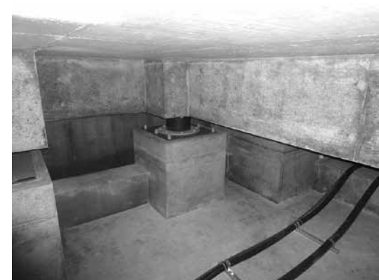
写真4 免震部（局舎下部）の構造
