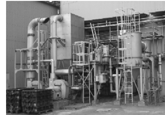
図7 排ガス処理設備外観
