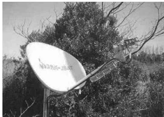
写真6 衛星通信設備
