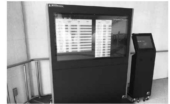
写真5 監視表示装置
