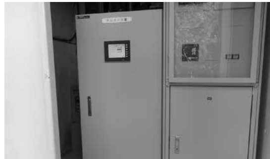
写真1 テレメータ子局装置
