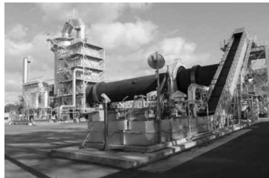
図2 仙台市仮設焼却炉外観
