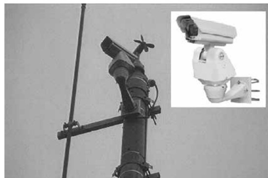
写真3 旋回型一方位監視カメラ
