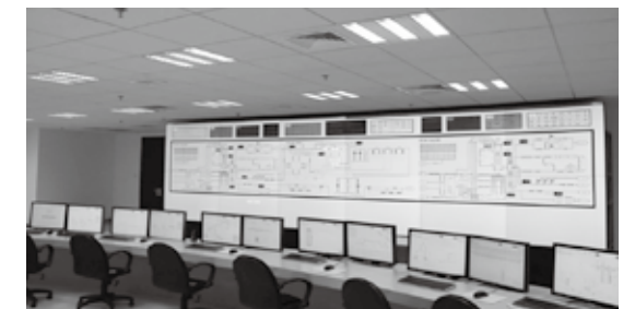
図12 HTR-PM運転シミュレーター 10)
