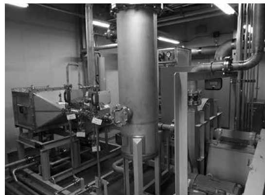
写真13 排煙廃液処理装置
