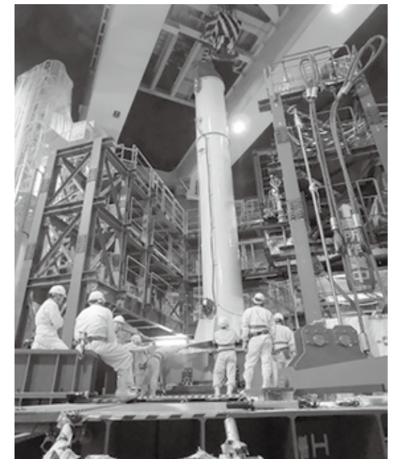
写真9 ガイド管取扱装置の炉上部設置（試料部把持装置などを收容した状態）
